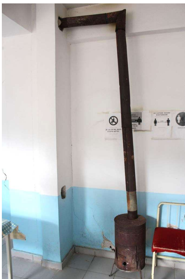
Die einzige Heizung in der provisorischen Station
