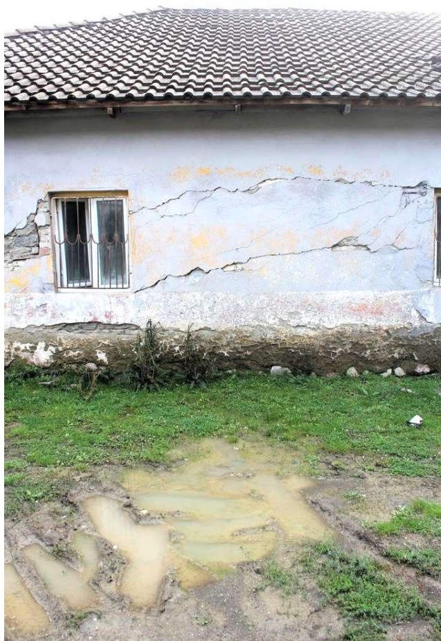
Die Schäden der Erdbeben sind gut sichtbar
