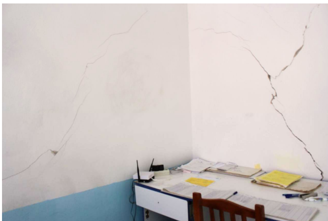
Die Schäden von den Erdbeben sind auch in diesem Raum sichtbar
