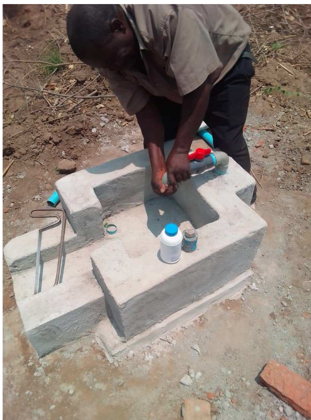
Einer der neuen Hydranten
