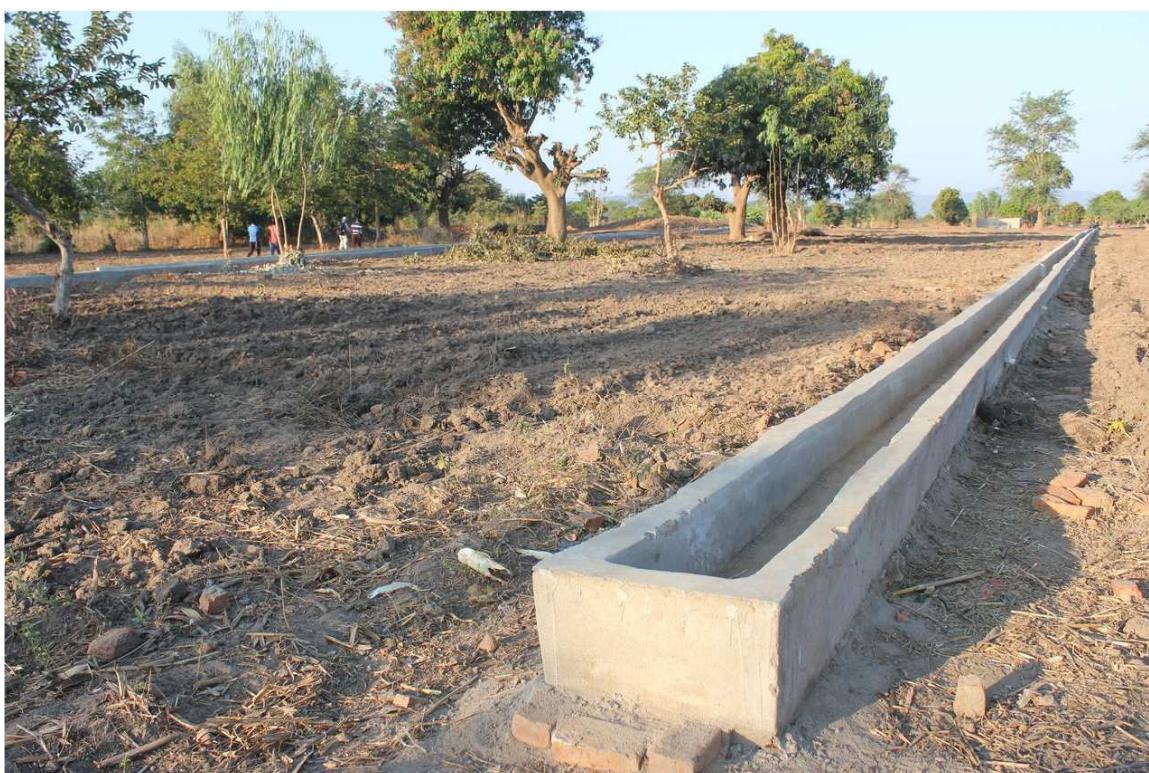
Auch die Kanäle waren falsch angelegt
