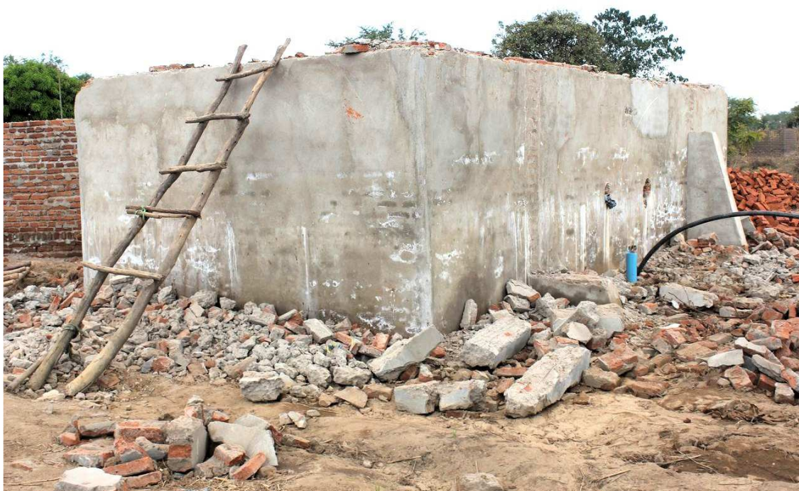
Zu schnell gebaut: Der erste Tank war bereits geborsten
